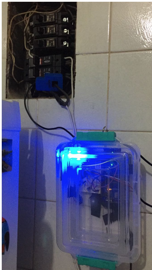
Figura 20. Dispositivo de monitoramento instalado no local.
