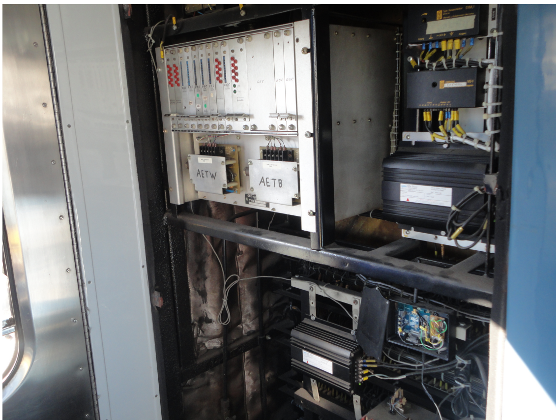
Figura 4-4. Perspectiva do Armário Elétrico do TUE 11.
